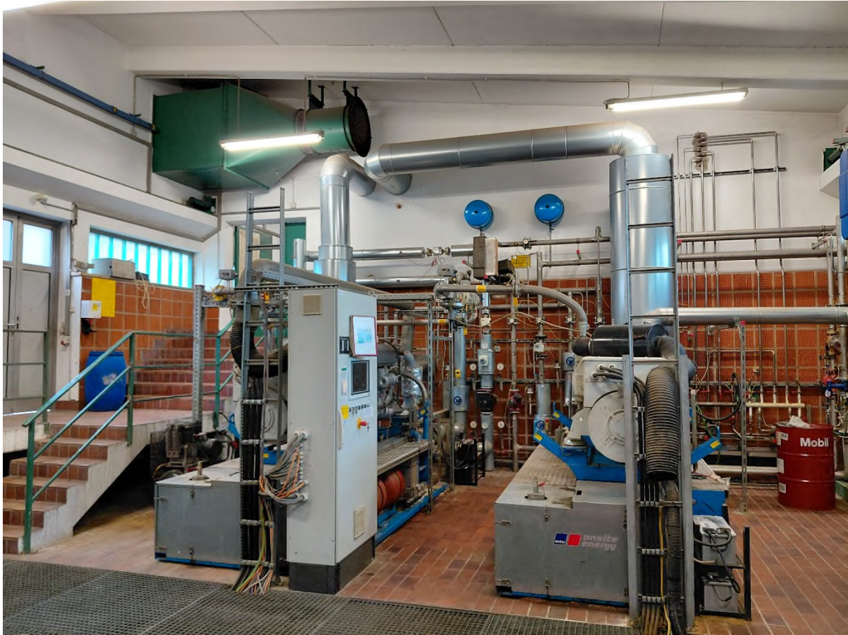
Abbildung 1: BHKW 1 und 2 (Bestand) mit Abgasanlage
