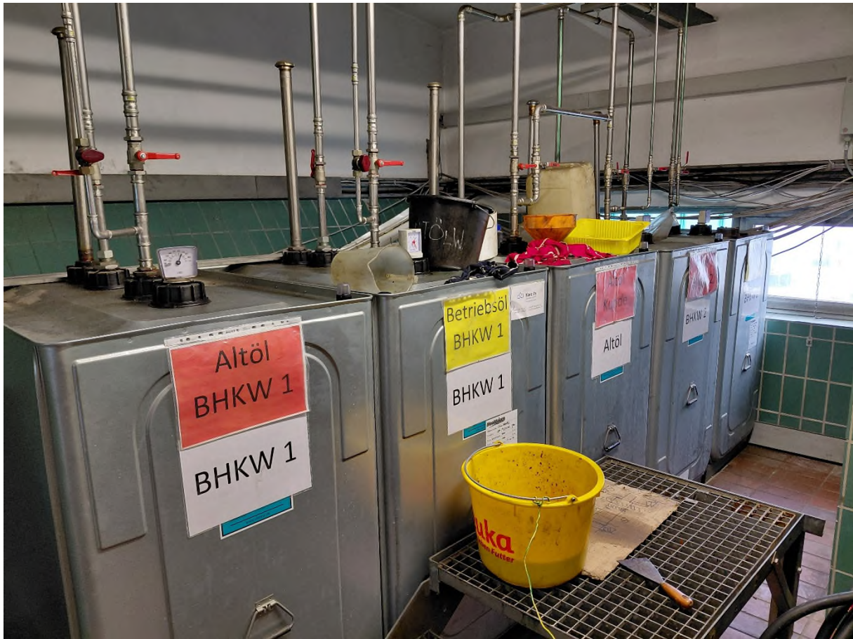
Abbildung 4: vorhandene Schmieröltanks (doppelwandig mit Leck Überwachungssystem)
