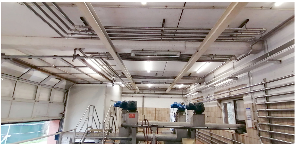
Rechengebäude: Kranschiene (Doppel-T-Träger)
