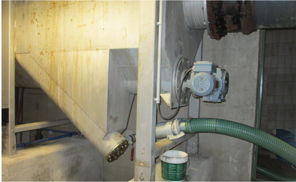
EG Rechengebäude: Sandfang - Lage Klassierschnecke
