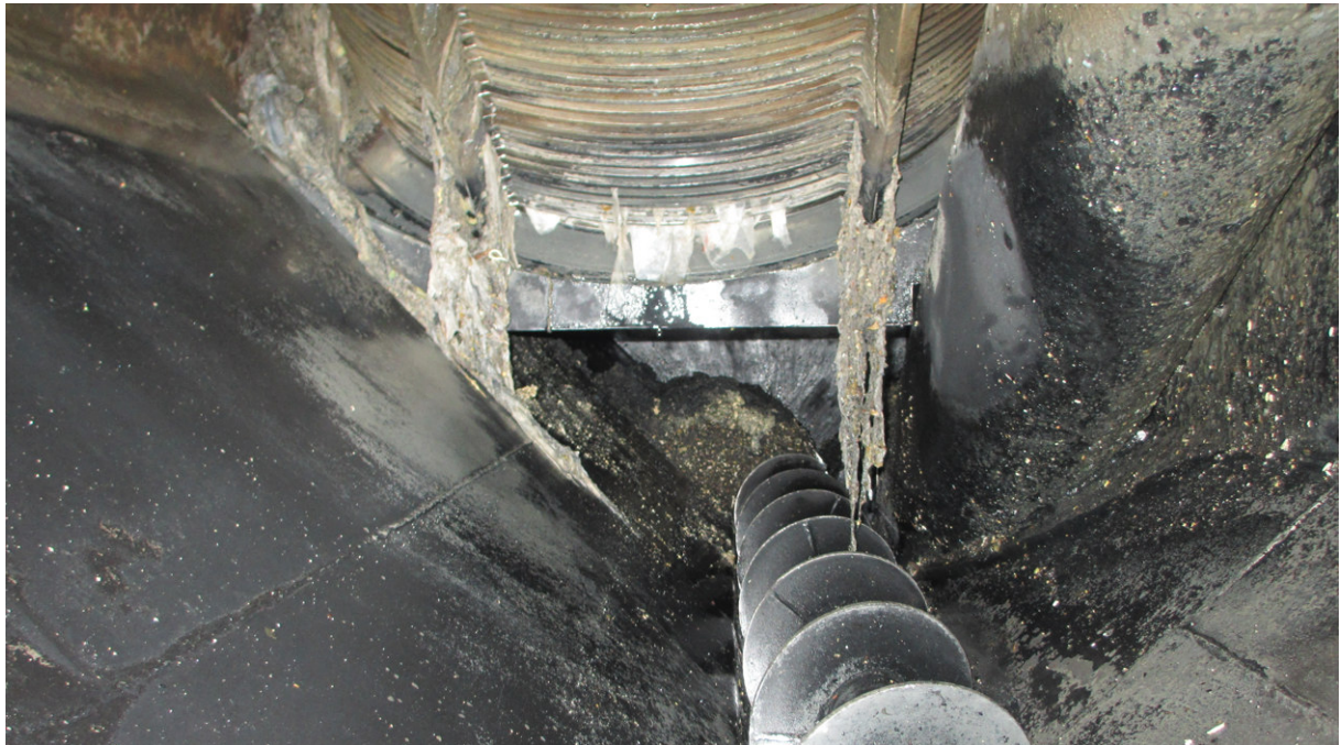
Rechengebäude: Querförderschnecke im Sandfang
