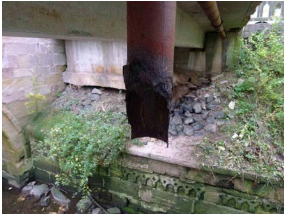
KORROSION FALLROHR ENTWÄSSERUNG
