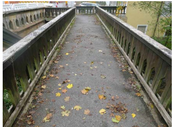
FUGE BELAG - GESIMSAUFKANTUNG OFFEN UND BEWACHSEN
