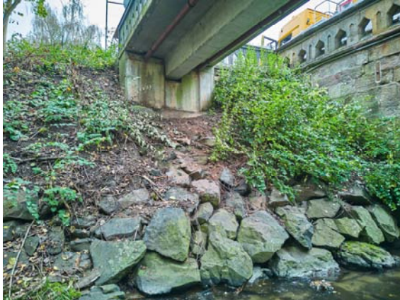
BÖSCHUNG WIEDERLAGER VORNE ABGESACKT
