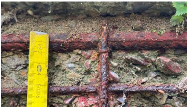
DETAILANSICHT ZU SCHADEN-NR 3
