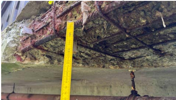
DETAILANSICHT ZU SCHADEN-NR 3 BETONGEFÜGE
