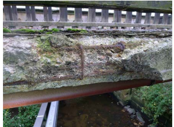
BETONABPLATZUNG MIT FREILIEGENDER BEWEHRUNG PLATTE 04
