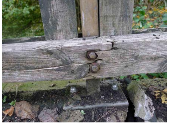
FUßHOLM GELÄNDER GEBROCHEN
