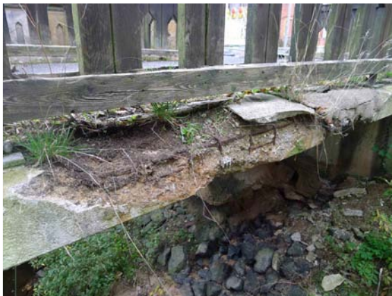
BETONABPLATZUNG MIT FREILIEGENDER BEWEHRUNG PLATTE 02
