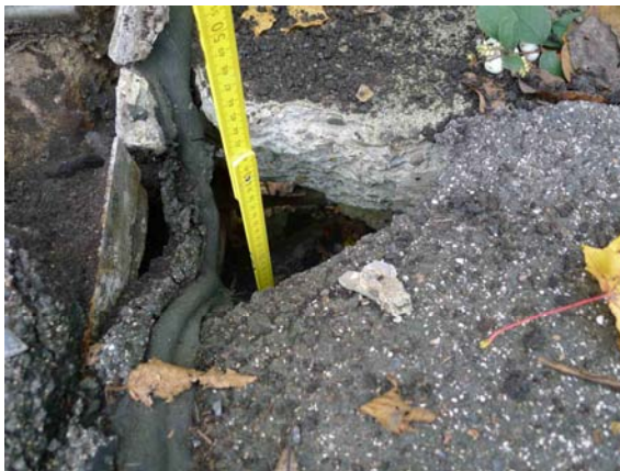
AUSWASCHUNG HINTERFÜLLBEREICH WIDERLAGER VORNE
