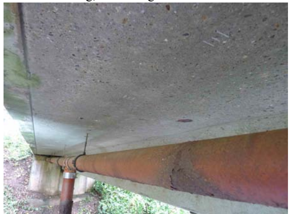
KORROSION LÄNGSLEITUNG ENTWÄSSERUNG
