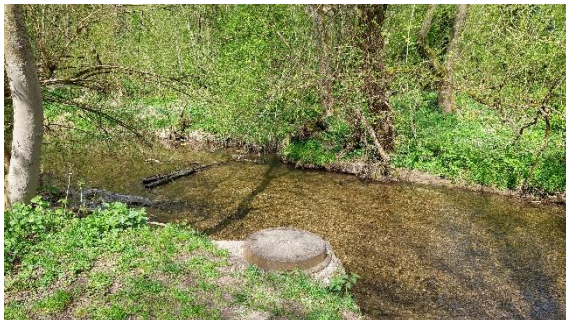
Peter-Rosegger-Straße (Schacht EI1148)
