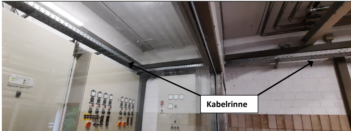
Kabelrinne zum Schachtanlagenraum
