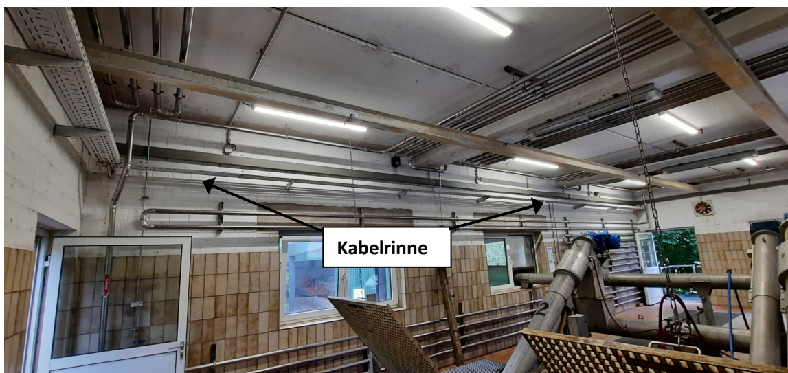
Kabelrinne im Rechengebäude
