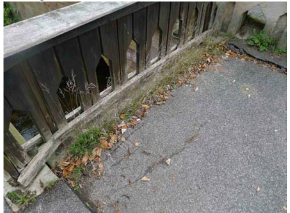
BEWUCHS FUGE BELAG - GESIMS
