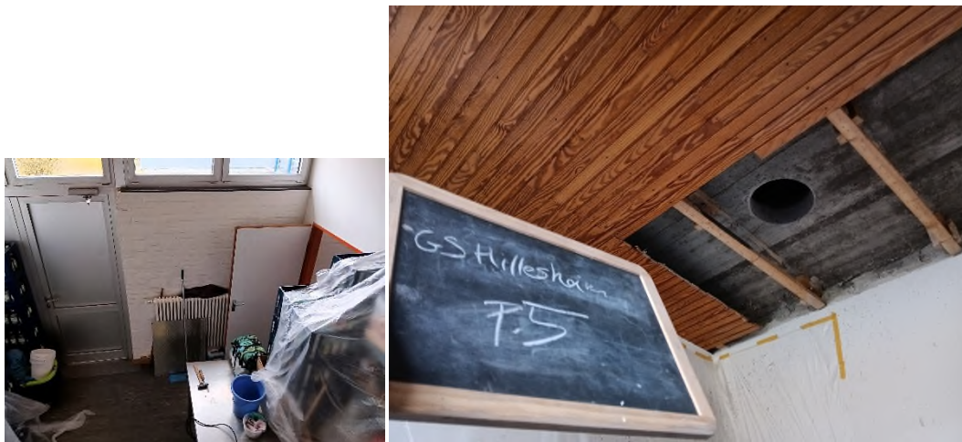
Abbildung 12: Raum "Kochen", Holz-Deckenverkleidung (P5, PCP-belastet)
