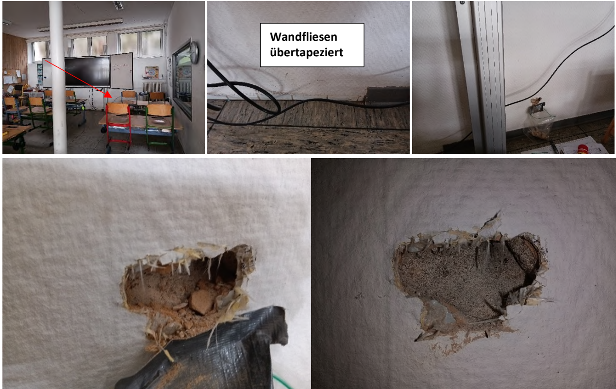
Abbildung 13: Klassenraum UG; Wandaufbau: Tapete – Kleber/Spachtelmasse? – Wandfliese (hellblau) – Dickbettmörtel?; keine klare Separierung der einzelnen Schichten, Mischprobe "P6 Wand" (Nachweis von 0,003 % Asbestfasern)
