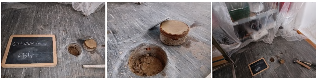
Abbildung 6: Kernbohrung KB 4 – EG; PVC-Kleber (auf Holz), asbest- und PCB-frei
