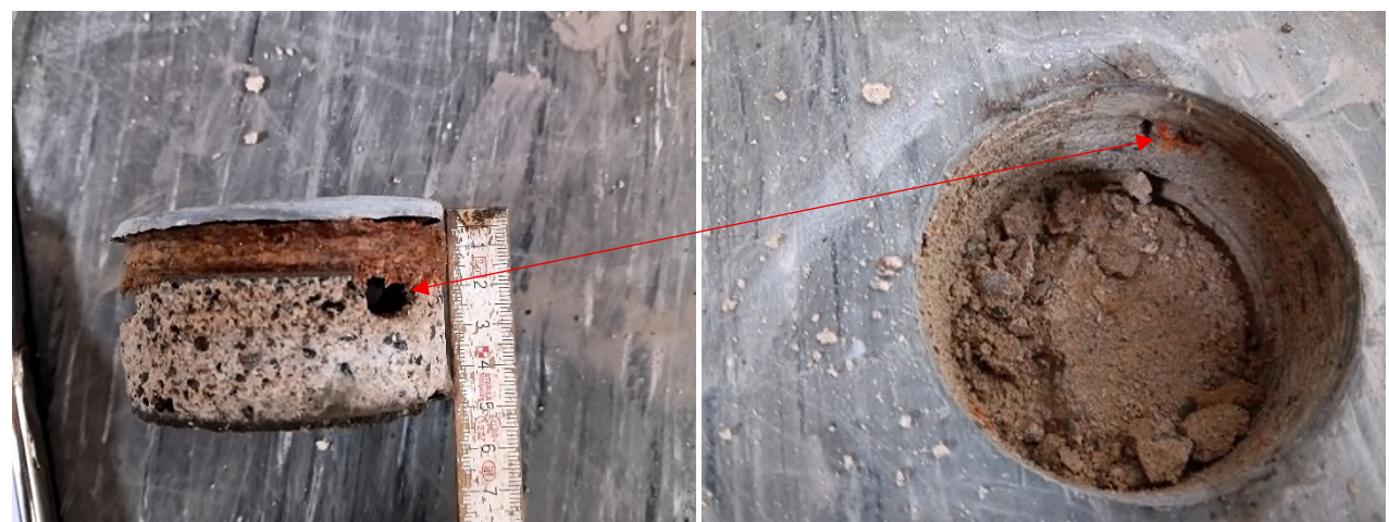
Abbildung 7: KB 4 "Bewehrungskabel" unterhalb Holzbodenplatte im Estrich
